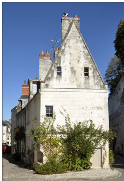
Végétation en pied d'immeuble, « maison d'Agnès » rue du Château, Loches
