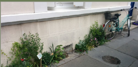
Végétalisation en pied de façade par des particuliers avec l'accord de la commune : une bonne manière de limiter l'humidité des murs. Espèces vivaces, basses, qui ne s'accrochent pas aux murs. Exemple du permis de végétaliser, ville de Tours (37).
