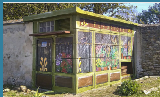
Exemple de poste électrique peint (src. ENEDIS)
