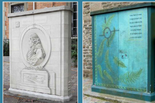
Exemples d'armoires électriques
